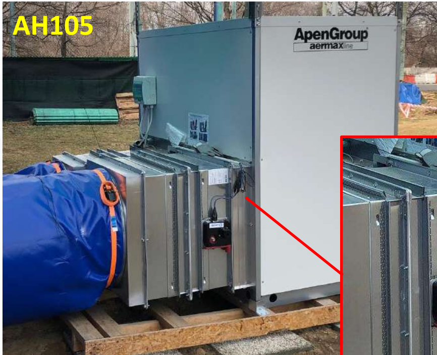
INSTALLATA A BORDO DEL CANALE DI MANDATA
